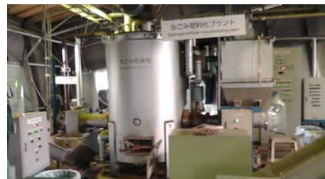
【生ごみ肥料化プラント】
