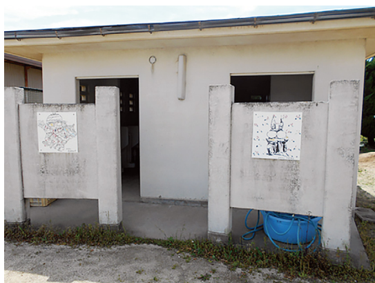
早期改修が望まれる北伊予小学校屋外トイレ
