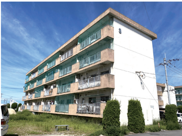
住環境の改善として改修が望まれる江川住宅外壁
