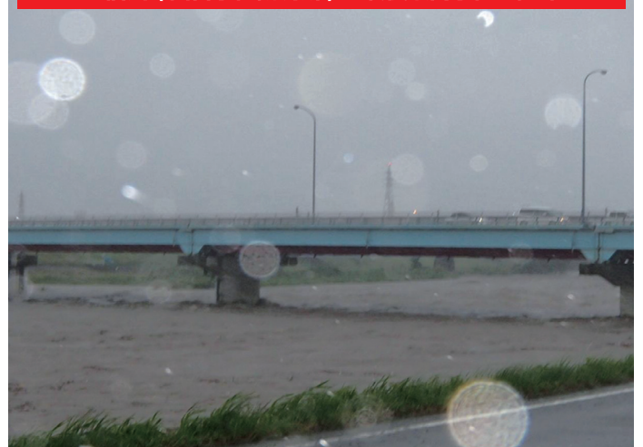
■重信川の出合橋の橋脚に迫る状況(9月17日16時43分)
