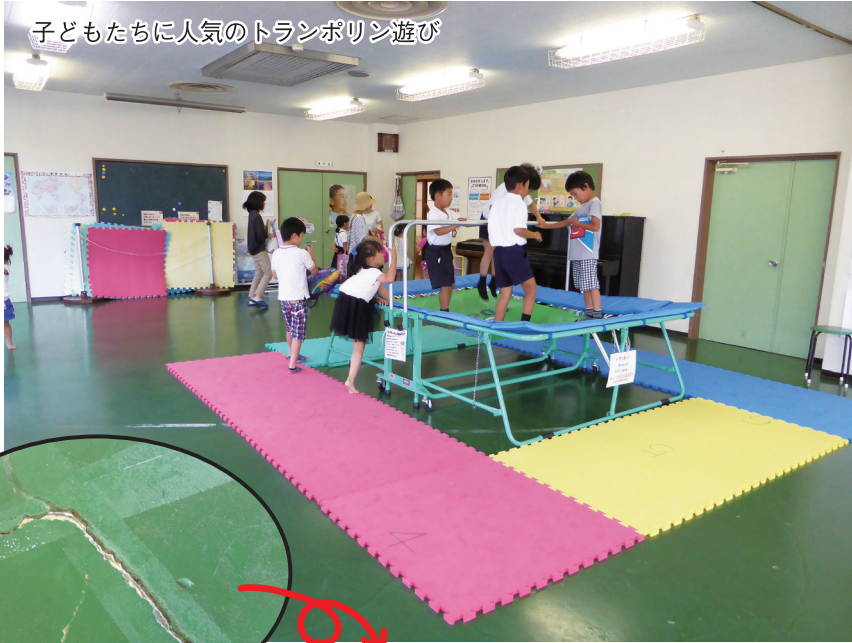
早く直して床のひび割れ
