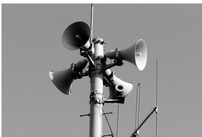
デジタル無線整備
