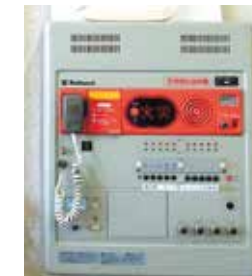
学校の火災ほうちせつび かさい
