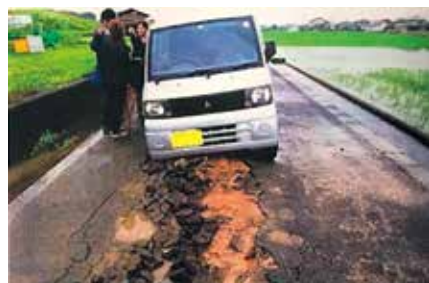
道路ほうかい(北川原地区)
